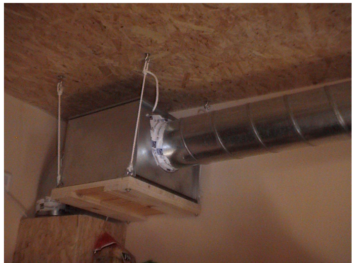
Caisson de ventilation
