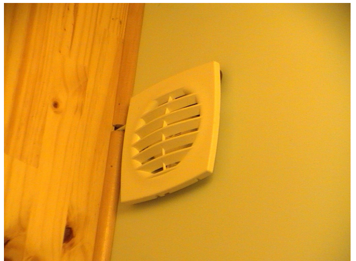
Extraction asservie à l'usage dans WC
