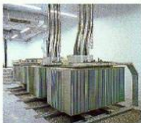
1000 kVA - 20 kV / 410 V
