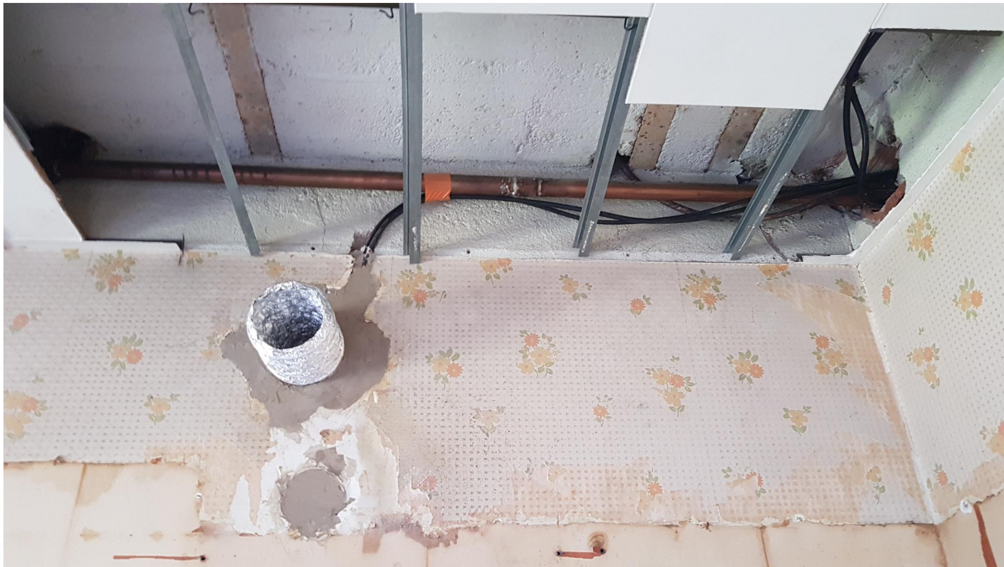
3a-Scellement de câbles (cuisine)
