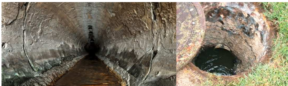
Photo 1 : égout et regard corrodés
