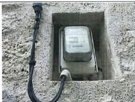
Photo du Compteur électrique
