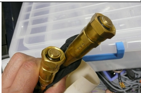
Les 2 tuyaux sortie unité intérieur
