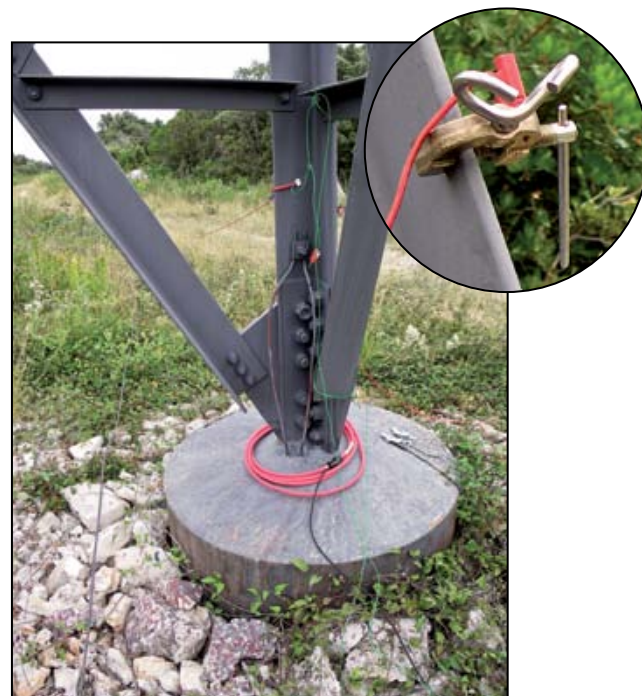
L'utilisation de capteurs AmpFLEX™ offre une grande souplesse vis à vis de la configuration du pylône
