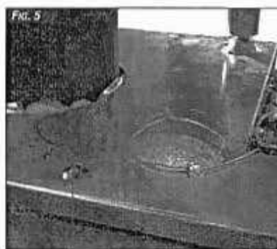
Fig. 5 Logement du bulbe du dispositif Caldo control (situé sur le dessus de la cheminée)
