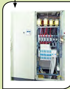
Batterie de condensateurs
