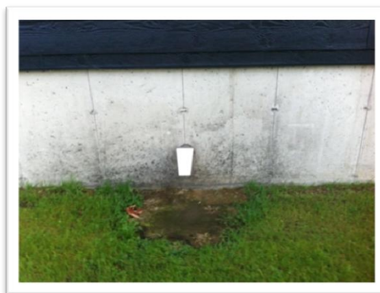
Image : accumulation de suie sur le revêtement extérieur
