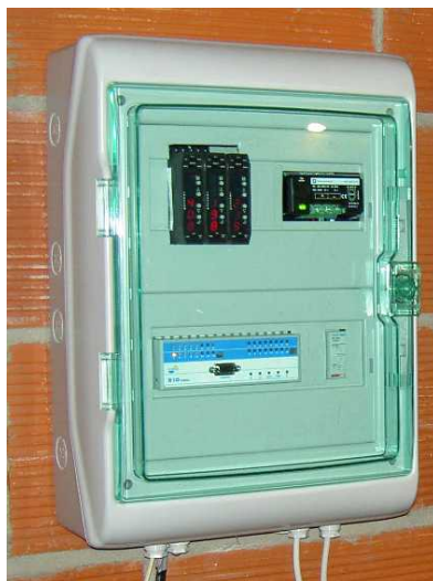
Figure 3 : Armoire électrique de l'instrumentation de niveau 2
