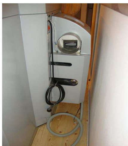
Vue extérieure du condenseur
