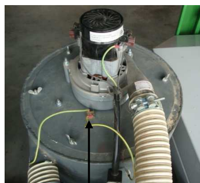
Mise à la terre côté trémie intermédiaire
