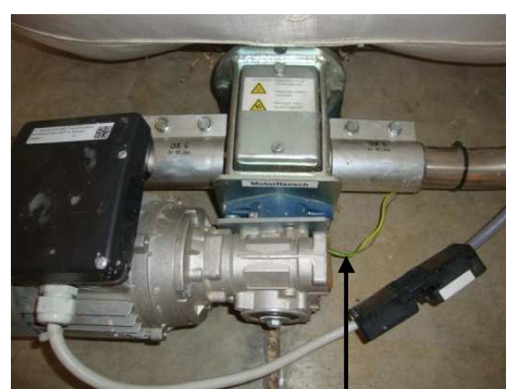
Mise à la terre côté silo
