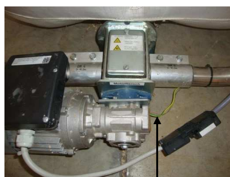
Mise à la terre côté silo
