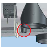
Evacuation permanente des condensats
