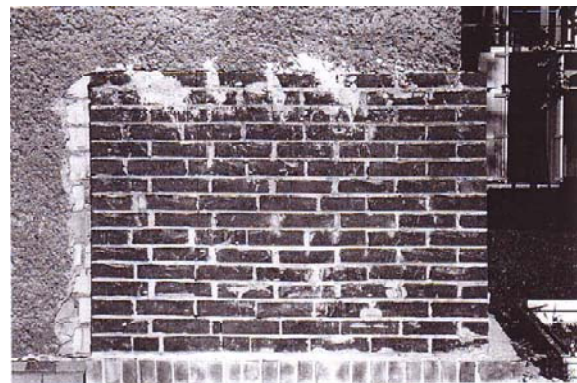
le mur du côté est non recouvert de crépi
