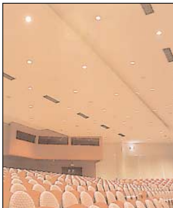
Un plafond acoustique.
