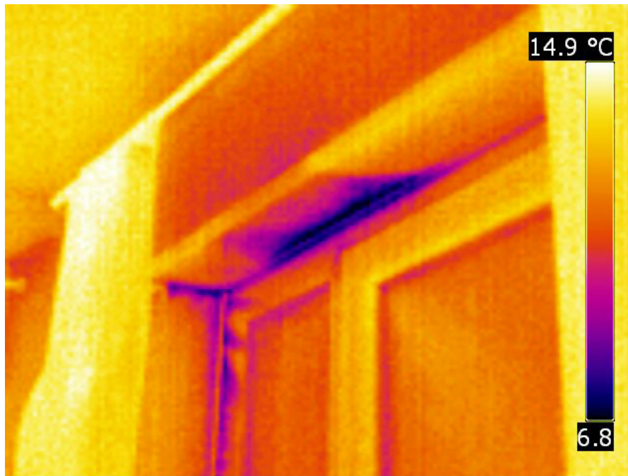
Raccord fenêtre / mur extérieur non étanche
