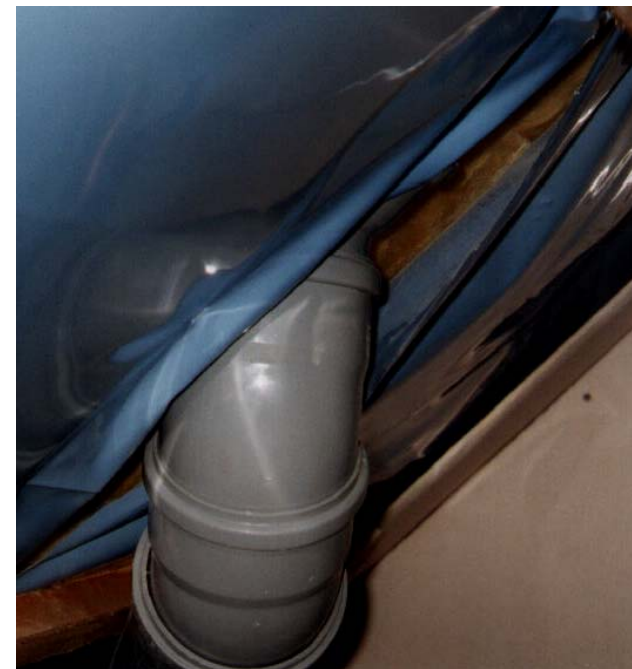
Passage de conduits non étanche
