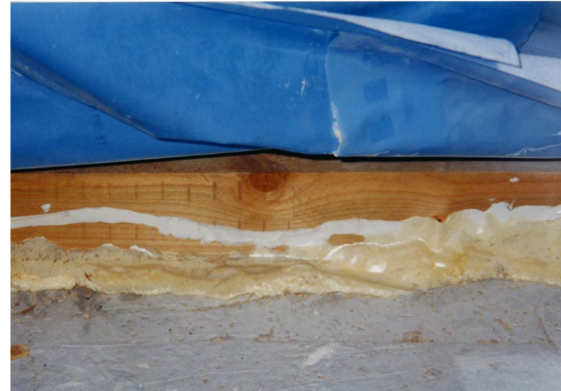
Utilisation de colles non adéquates
