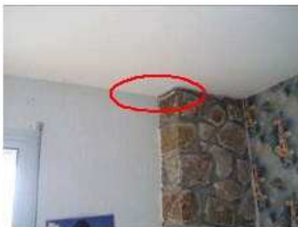
Angle de la cheminée dans la chambre.
