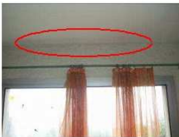
Angle intérieur entre caisson de volet et plafond.
