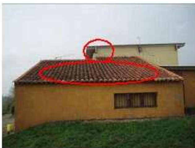
Toiture en tuiles canal pas isolée au dessus du bureau.
