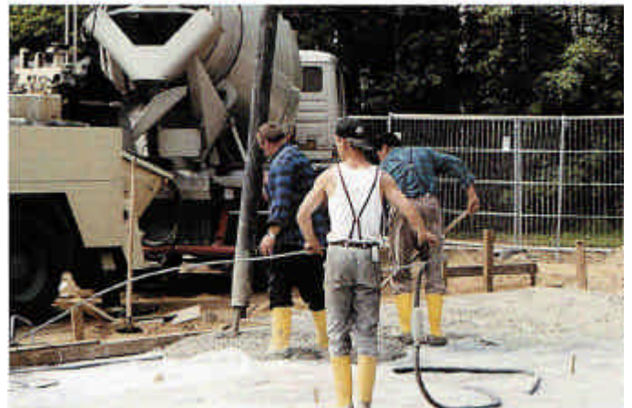
Coulage de béton à fibres d'acier Fortius dans un coffrage de mur de cave
